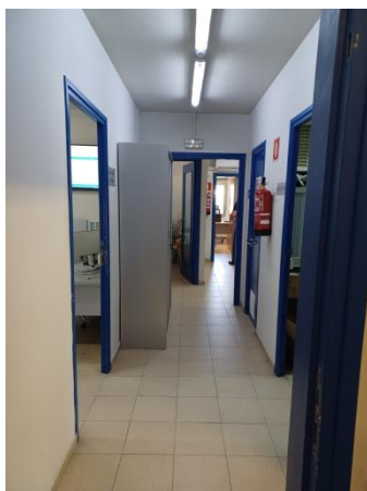
Imatge on es pot veure que manca la senyalització d'emergència i evacuació
